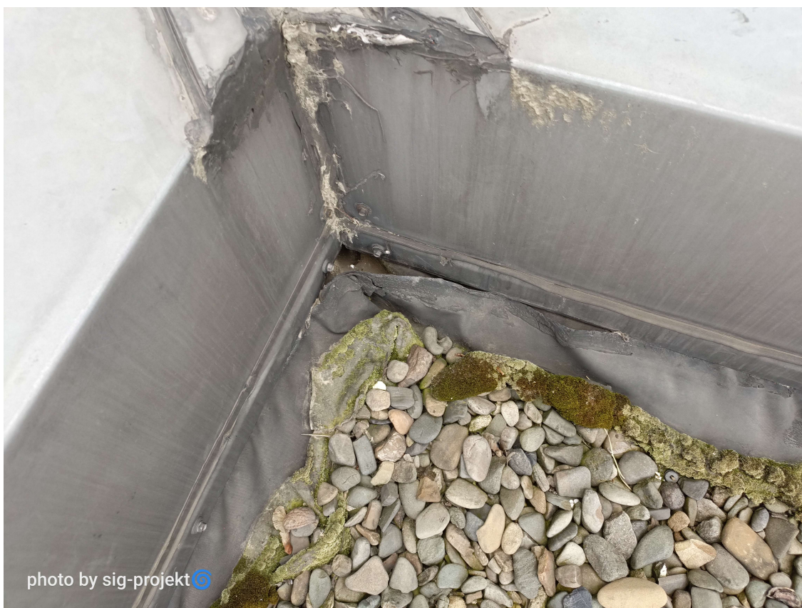
Zdj. nr 2 - odspojona membrana przy świetliku
